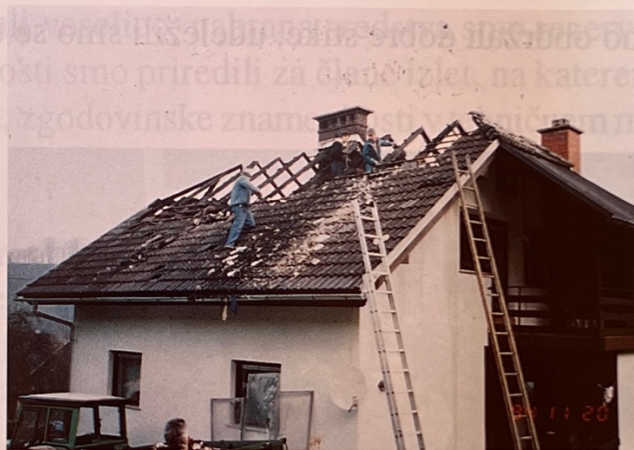
Hiša po požaru pri Frelihovih (Zgorevovih)
